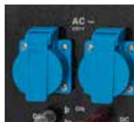
Dos tomacorrientes monofásicos (230 V CA 50 Hz)
