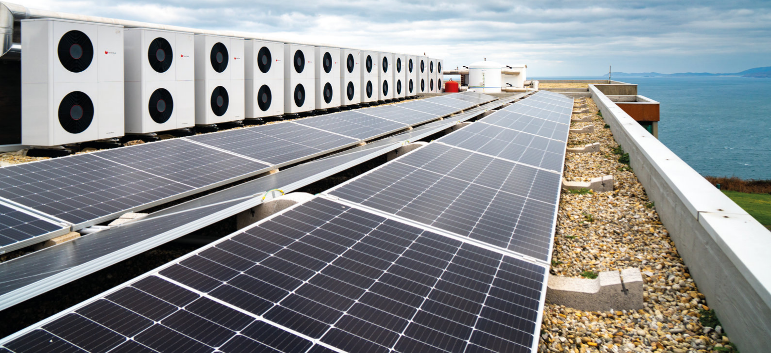
Instalaciones de Genia Air Max en cascada en restaurante y centro deportivo de La Coruña. Más información en re-magazine.saunierduval.es
