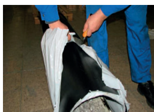
1. Una vez soldado el tubo de acero, deslizar la camisa que previamente se ha introducido en unos de los tubos.
