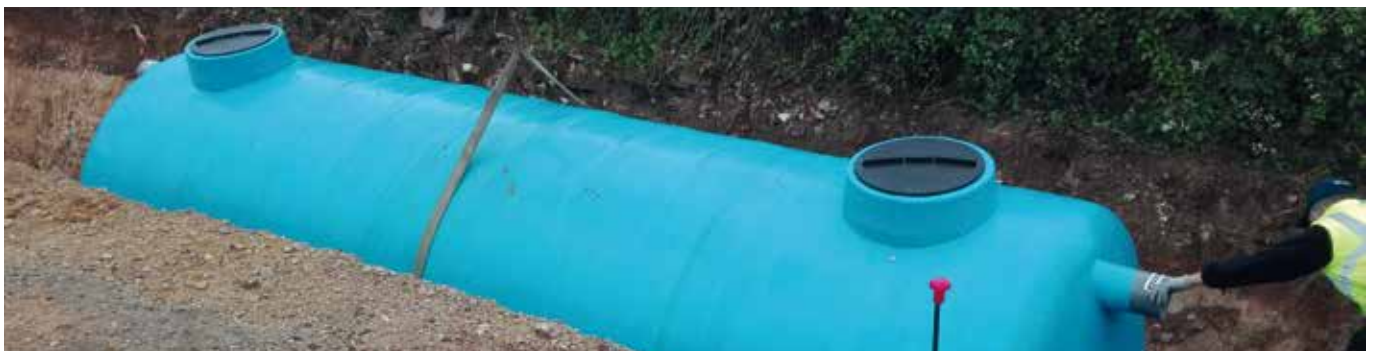
Instalación depósito DRP-F
