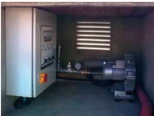
Cuadro eléctrico y compresor
