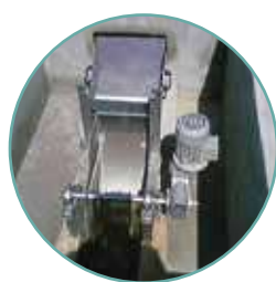
reja de desbaste automática
