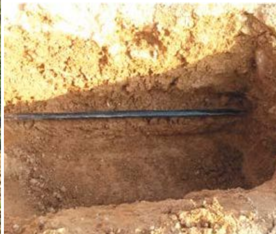
Foto 7. Tubería de riego subterráneo.
