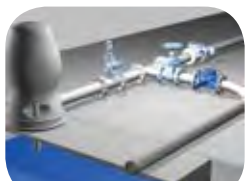
Válvula de Control de Bomba en Pozo profundo
